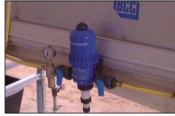
Unidad de dosificado químico.
