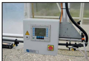
Новый щит управления с более гибкими функциями
